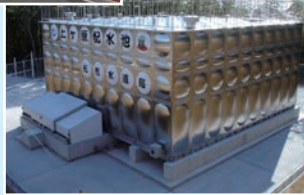
うえがはら 上ヶ原配水池：400 m 3 (左：上ヶ原ポンプ所)
